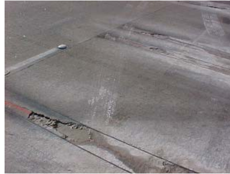
Figura 1 - Agrietamiento y Delaminado
