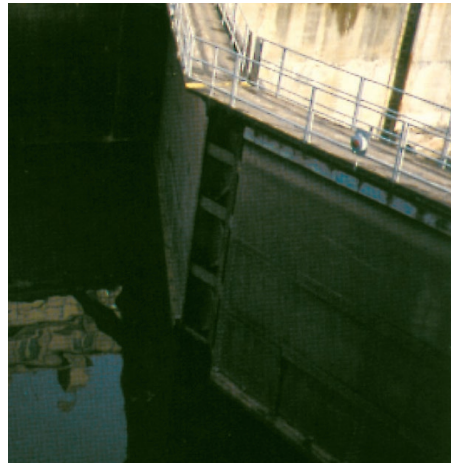
Esclusas permanecen abiertas mientras que se hacen reparaciones sub-acuáticas con concreto tratado con aditivo anti-deslave RHEOMAC UW450.
