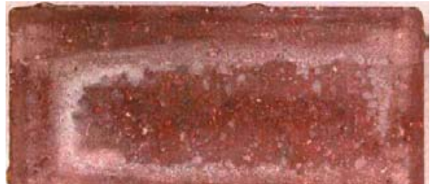
Figura 9. El bloque de concreto que muestra el fenómeno de eflorescencia conocido como enmarcado. El proporcionar una adecuada convección durante el proceso de curado puede prevenir esto. La eflorescencia está compuesta de carbonato de calcio.
